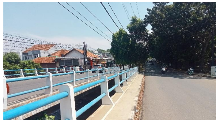
KONDISI SANDARAN DAN TROTOAR
