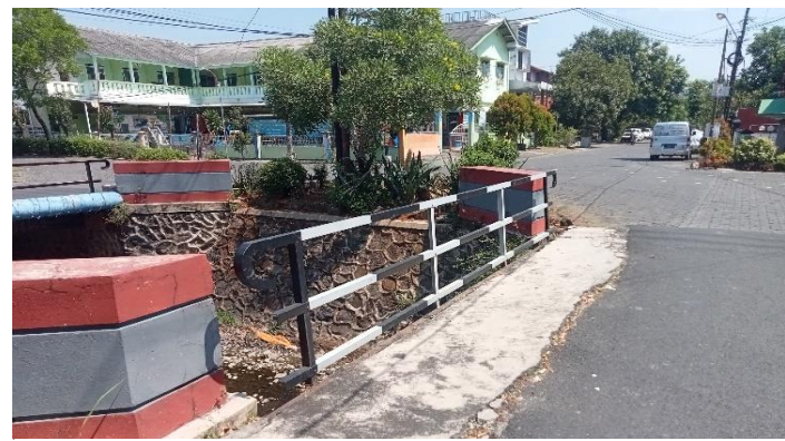
KONDISI SANDARAN DAN TROTOAR
