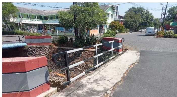
KONDISI SANDARAN DAN TROTOAR
