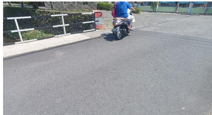
KONDISI LAPISAN PERMUKAAN LANTAI
