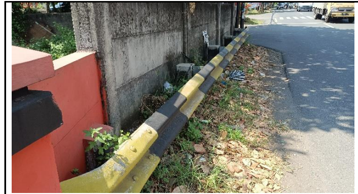
KONDISI GUARD RAIL PENGAMAN JALAN PENDEKAT
