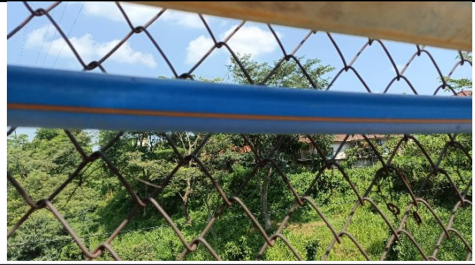
KONDISI PIPA UTILITAS PROVIDER
