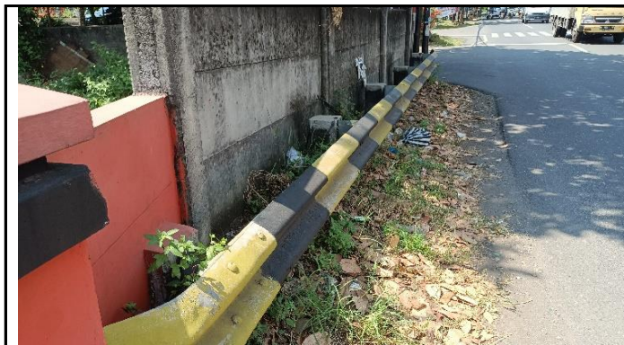
KONDISI GUARD RAIL PENGAMAN JALAN PENDEKAT
