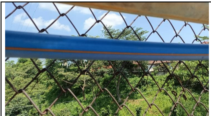
KONDISI PIPA UTILITAS PROVIDER
