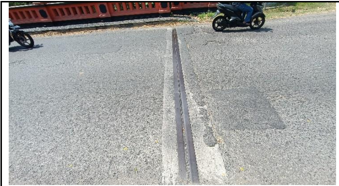
KONDISI SAMBUNGAN SIAR MUAI
