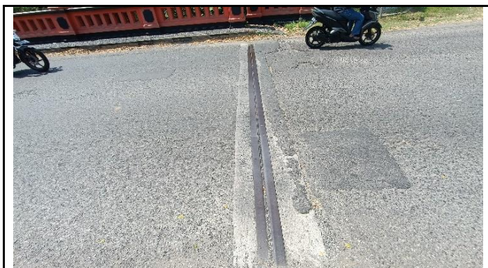
KONDISI SAMBUNGAN SIAR MUAI
