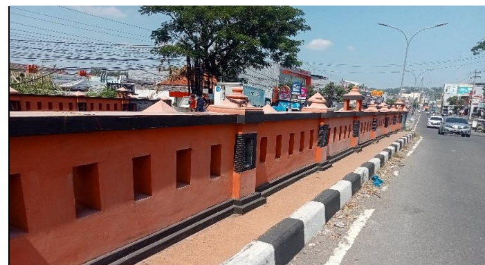
KONDISI SANDARAN DAN TROTOAR
