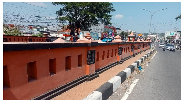
KONDISI SANDARAN DAN TROTOAR
