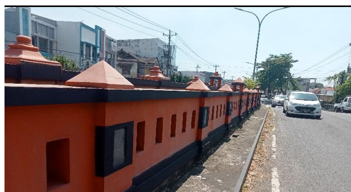
KONDISI SANDARAN DAN TROTOAR
