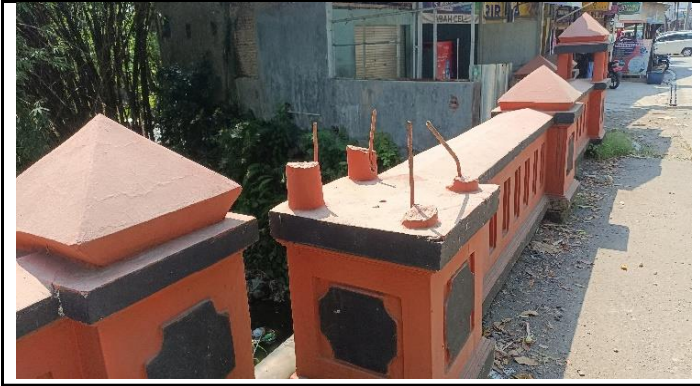
KERUSAKAN PADA SANDARAN
