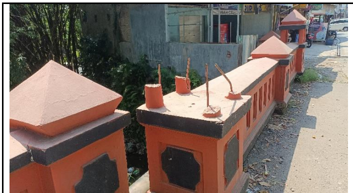
KERUSAKAN PADA SANDARAN
