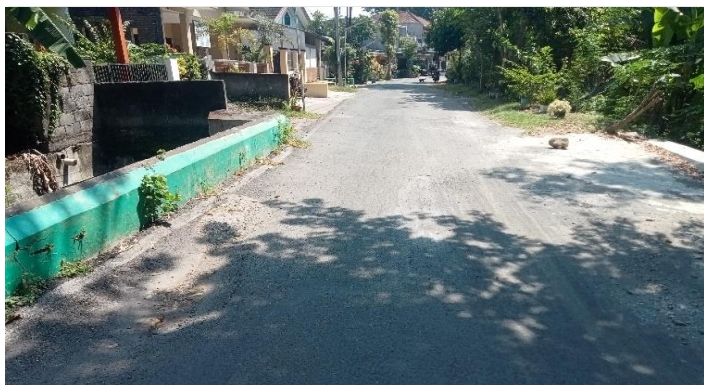
LAPISAN PERMUKAAN LANTAI BERGELOMBANG
