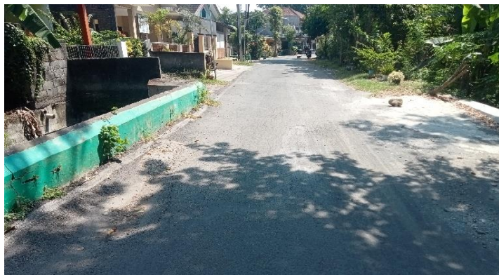
LAPISAN PERMUKAAN LANTAI BERGELOMBANG
