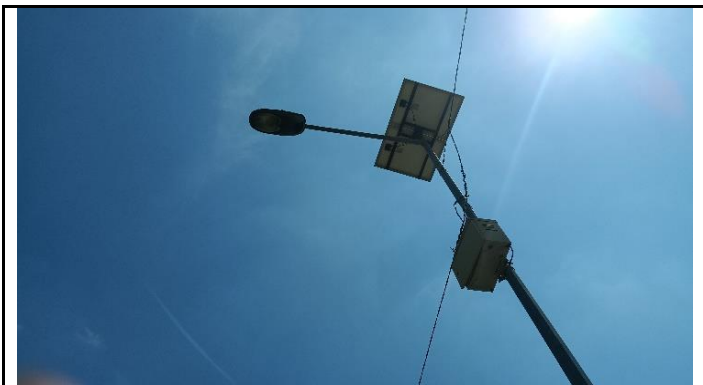
KONDISI LAMPU PENERANGAN JEMBATAN
