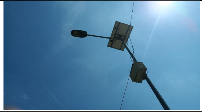
KONDISI LAMPU PENERANGAN JEMBATAN
