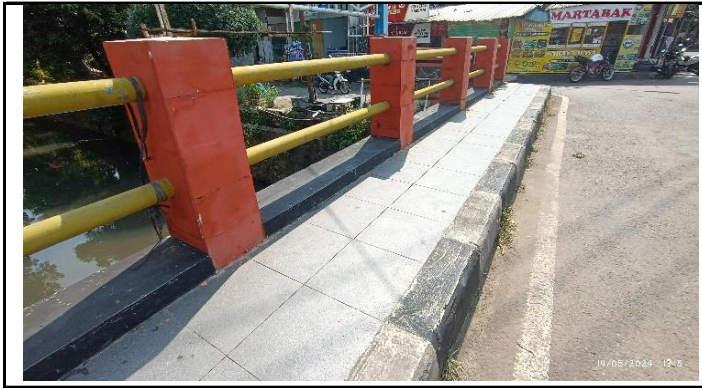
KONDISI TROTOAR DAN SANDARAN
