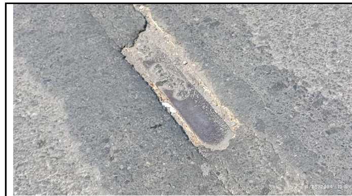
ASPAL PADA SAMBUNGAN LANTAI TERKELUPAS
