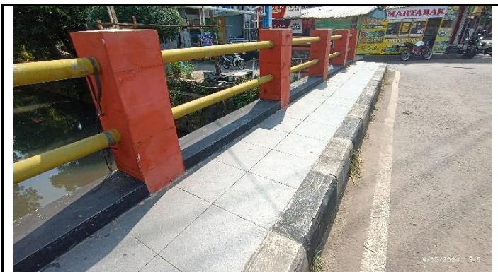
KONDISI TROTOAR DAN SANDARAN
