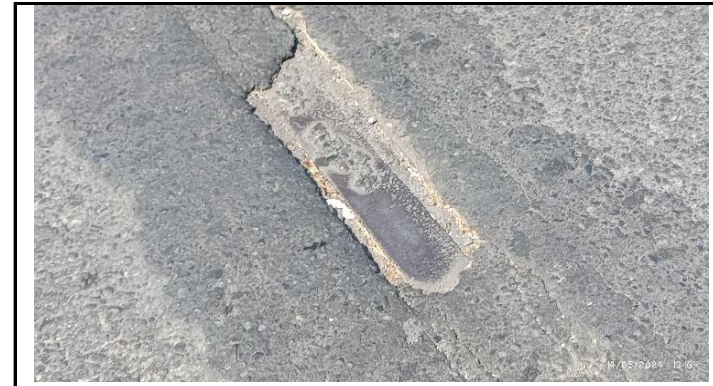
ASPAL PADA SAMBUNGAN LANTAI TERKELUPAS
