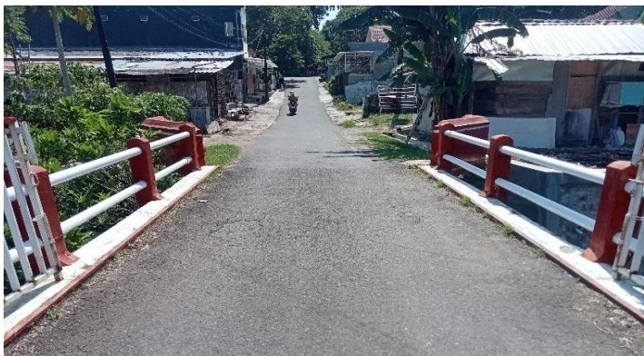
KONDISI LAPISAN PERMUKAAN LANTAI
