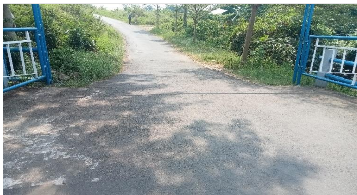
KONDISI LAPISAN PERMUKAAN LANTAI
