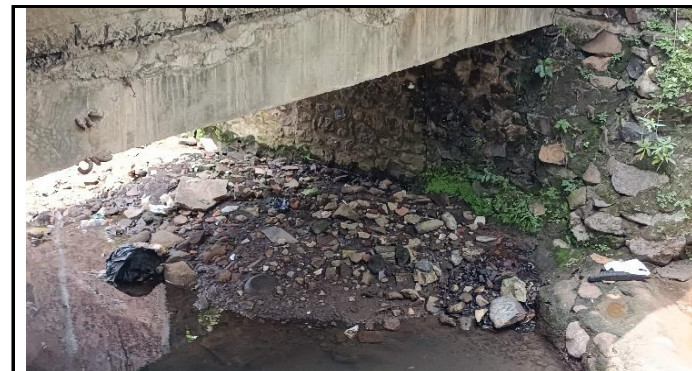
KEPALA JEMBATAN BERLUMUT DAN KOTOR
