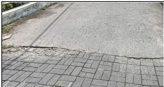
JALAN PENDEKAT BERGELOMBANG
