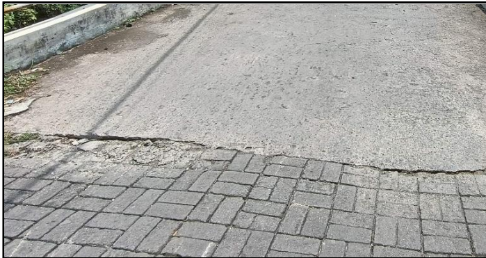
JALAN PENDEKAT BERGELOMBANG
