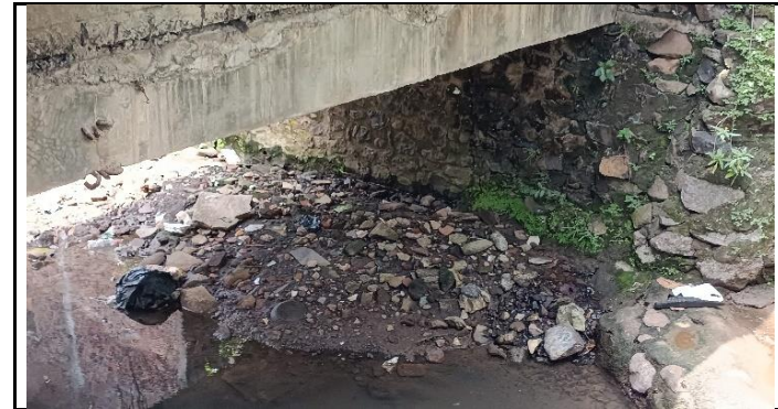
KEPALA JEMBATAN BERLUMUT DAN KOTOR
