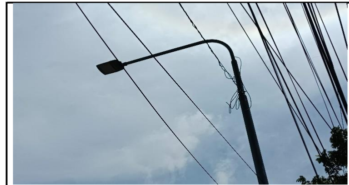
KONDISI PENERANGAN JEMBATAN
