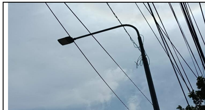
KONDISI PENERANGAN JEMBATAN
