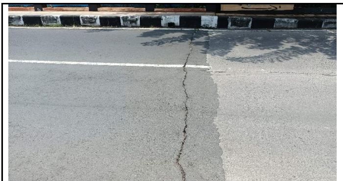
SAMBUNGAN LANTAI JEMBATAN RETAK
