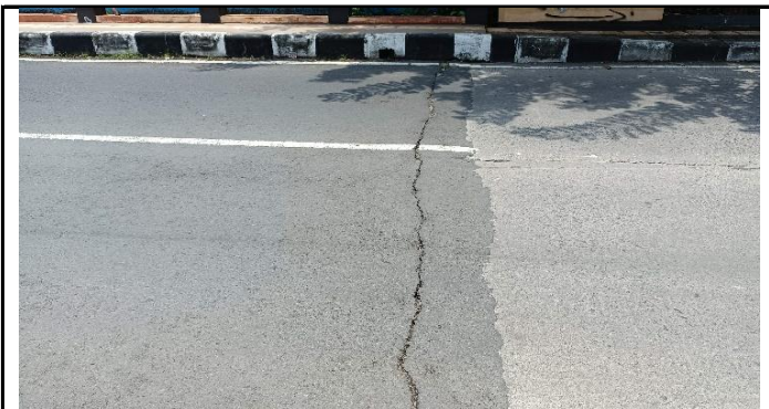
SAMBUNGAN LANTAI JEMBATAN RETAK
