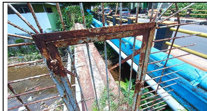
KONDISI UTILITAS BERKARAT
