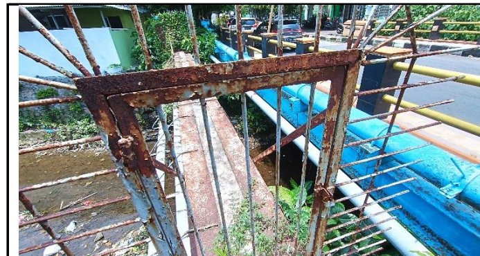
KONDISI UTILITAS BERKARAT
