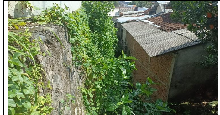
PENURUNAN MUTU BATU PADA DINDING PENAHAN TANAH JALAN PENDEKAT
