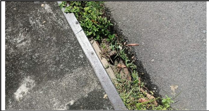
KONDISI DRAINASE LANTAI
