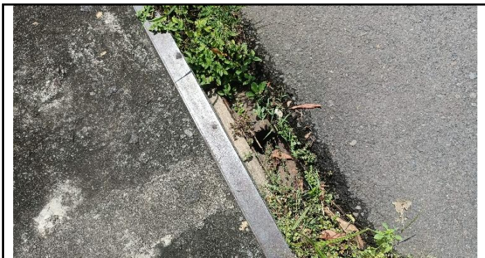
KONDISI DRAINASE LANTAI
