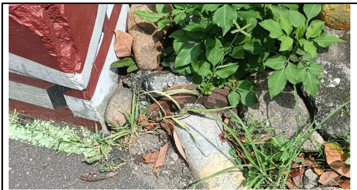
KERETAKAN PADA STRUKTUR JALAN PENDEKAT
