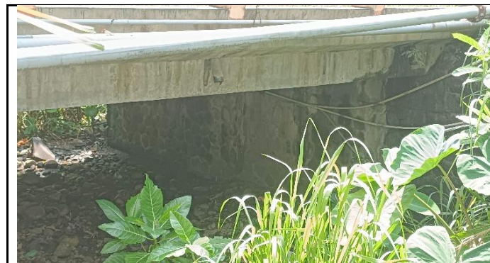
KONDISI KEPALA JEMBATAN DAN GELAGAR
