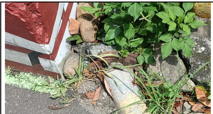
KERETAKAN PADA STRUKTUR JALAN PENDEKAT
