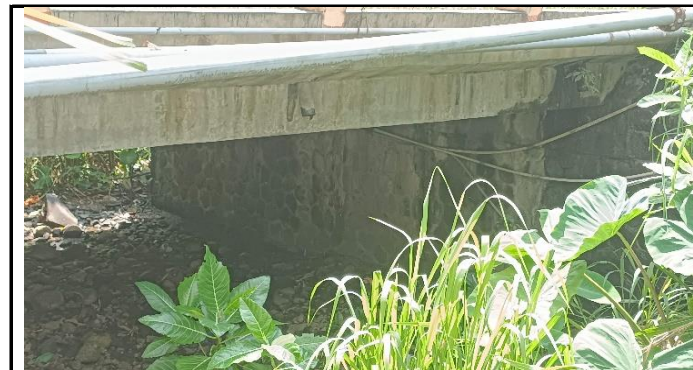
KONDISI KEPALA JEMBATAN DAN GELAGAR
