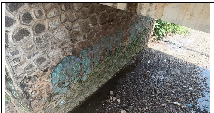
KEPALA JEMBATAN MENGALAMI PENURUNAN MUTU
