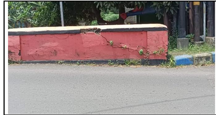
TEMBOK SEDADA RETAK
