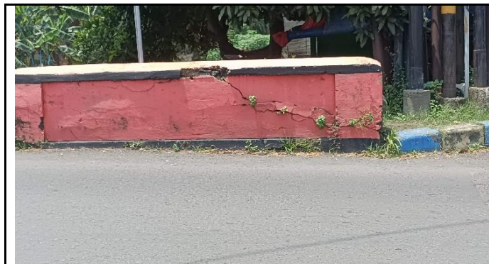
TEMBOK SEDADA RETAK
