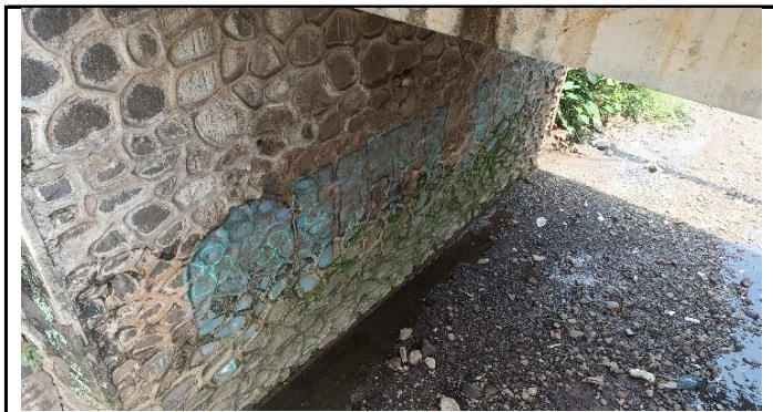
KEPALA JEMBATAN MENGALAMI PENURUNAN MUTU
