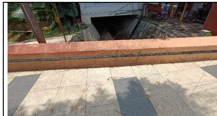
KONDISI TROTOAR DAN SANDARAN
