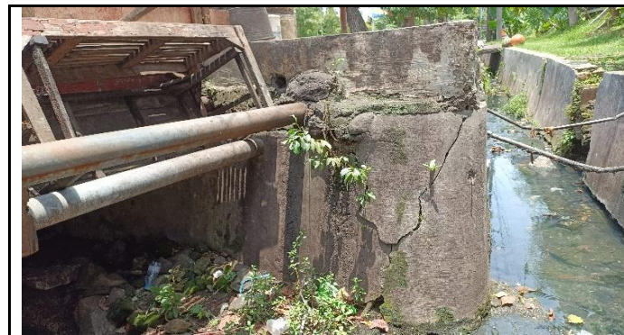
KONDISI KEPALA JEMBATAN RETAK
