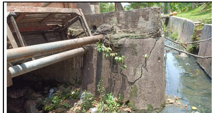
KONDISI KEPALA JEMBATAN RETAK
