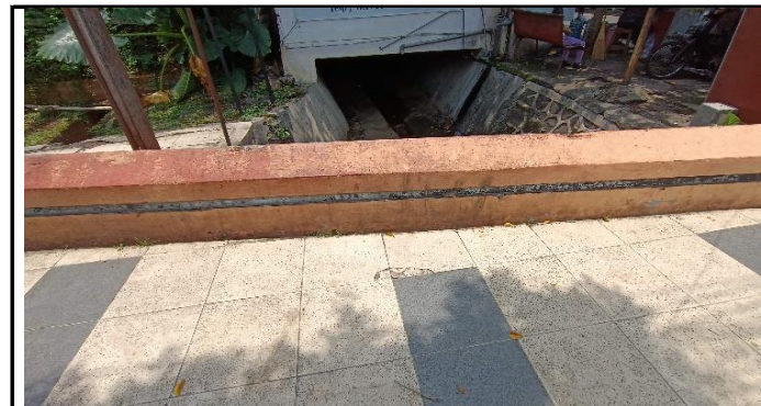
KONDISI TROTOAR DAN SANDARAN
