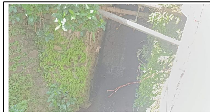
KONDISI KEPALA JEMBATAN BERLUMUT
