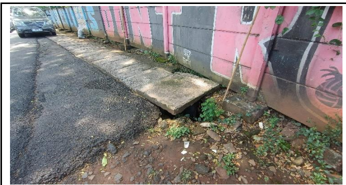
KONDISI SANDARAN TIDAK ADA PADA SATU SISI
