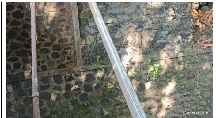
KONDISI PIPA UTILITAS BERKARAT
