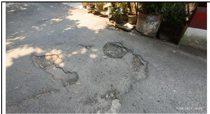
LAPISAN PERMUKAAN JALAN PENDEKAT BERLUBANG
