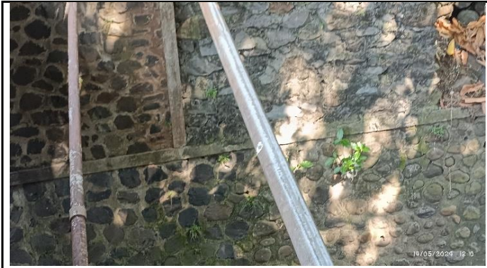
KONDISI PIPA UTILITAS BERKARAT
