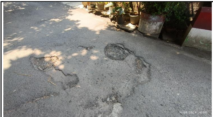
LAPISAN PERMUKAAN JALAN PENDEKAT BERLUBANG
