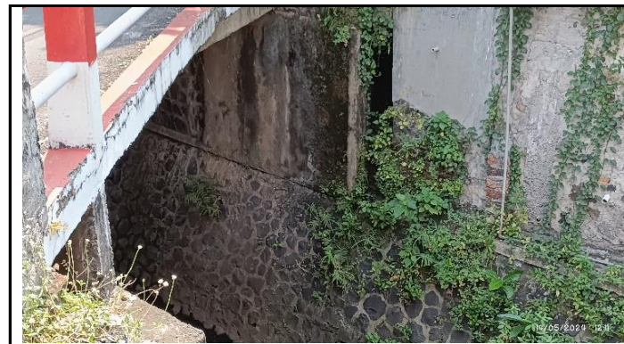
KONDISI KEPALA JEMBATAN BERLUMUT
