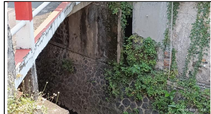
KONDISI KEPALA JEMBATAN BERLUMUT
