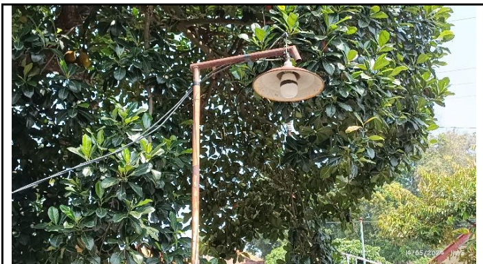
KONDISI LAMPU PENERANGAN JEMBATAN
