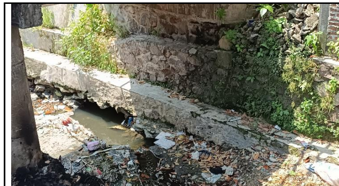
KONDISI KEPALA JEMBATAN BERLUMUT
