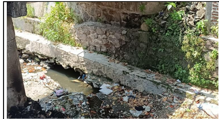
KONDISI KEPALA JEMBATAN BERLUMUT
