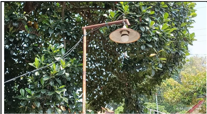
KONDISI LAMPU PENERANGAN JEMBATAN
