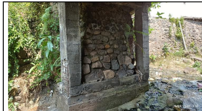
KEPALA JEMBATAN MENGALAMI PENURUNAN MUTU
