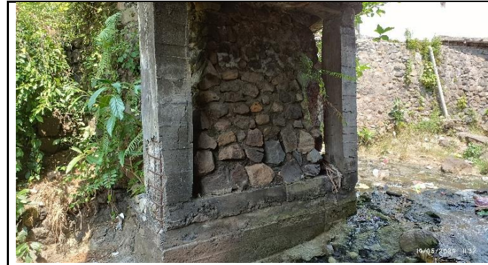
KEPALA JEMBATAN MENGALAMI PENURUNAN MUTU
