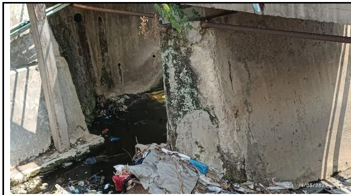
KONDISI PILAR BERLUMUT
