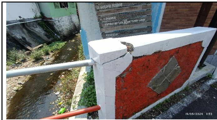
KERETAKAN PADA PARAPET SANDARAN
