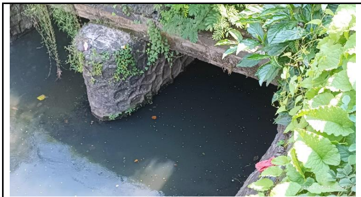
KONDISI PILAR MENGALAMI PENURUNAN MUTU
