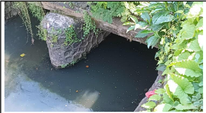
KONDISI PILAR MENGALAMI PENURUNAN MUTU
