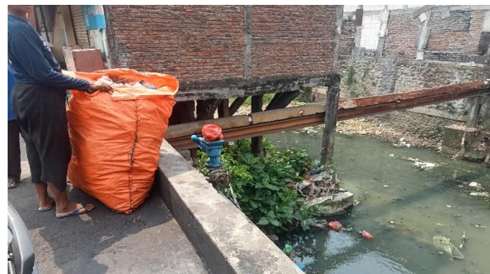
KONDISI SANDARAN TIDAK STANDART
