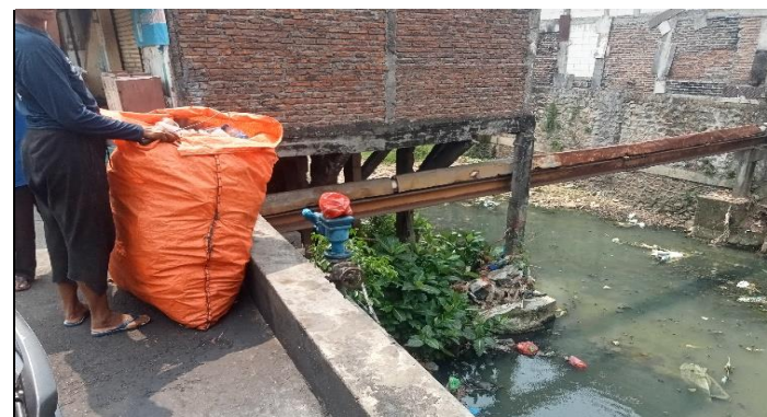
KONDISI SANDARAN TIDAK STANDART
