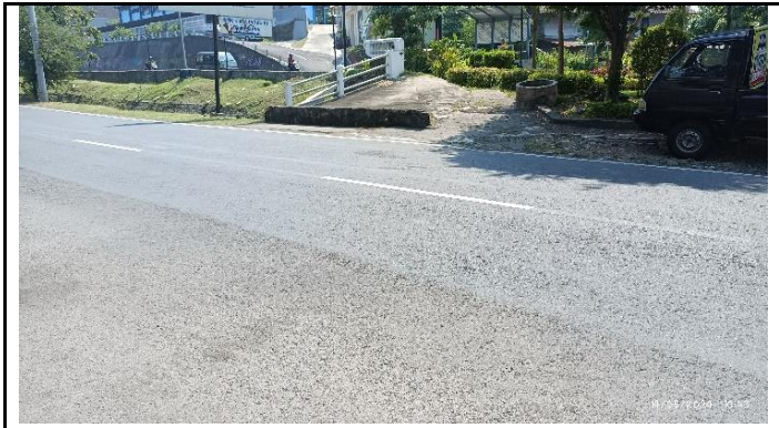
KONDISI LAPISAN PERMUKAAN LANTAI
