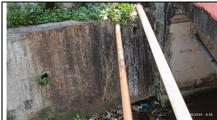
PIPA UTILITAS BERKARAT
