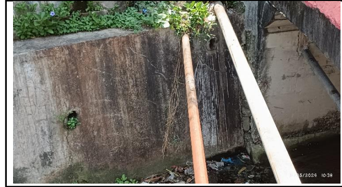
PIPA UTILITAS BERKARAT
