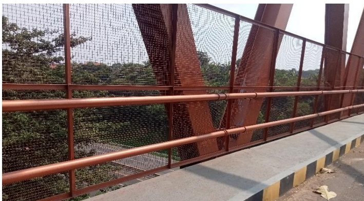
KONDISI SANDARAN DAN TROTOAR
