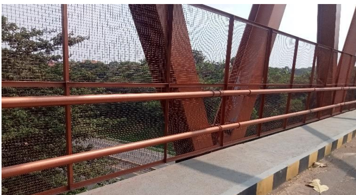
KONDISI SANDARAN DAN TROTOAR
