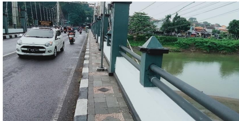
KONDISI SANDARAN DAN TROTOAR
