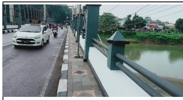
KONDISI SANDARAN DAN TROTOAR
