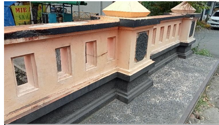
KONDISI SANDARAN DAN TROTOAR
