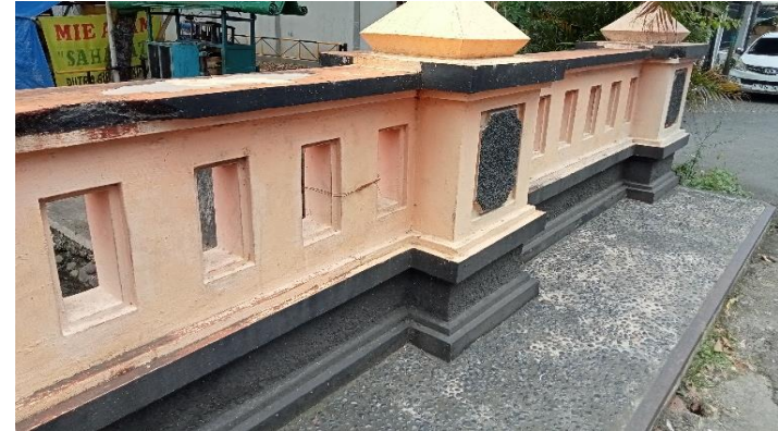
KONDISI SANDARAN DAN TROTOAR
