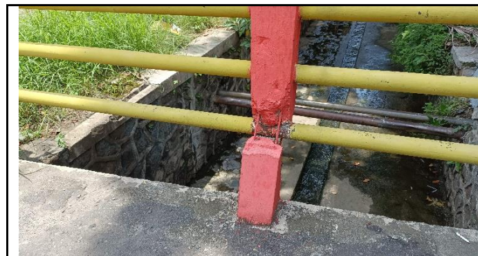
TIANG SANDARAN PECAH
