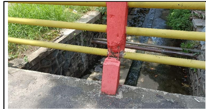
TIANG SANDARAN PECAH
