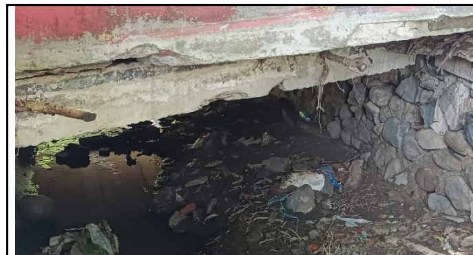
PELAT JEMBATAN KEROPOS DAN RONTOK PADA BETON
