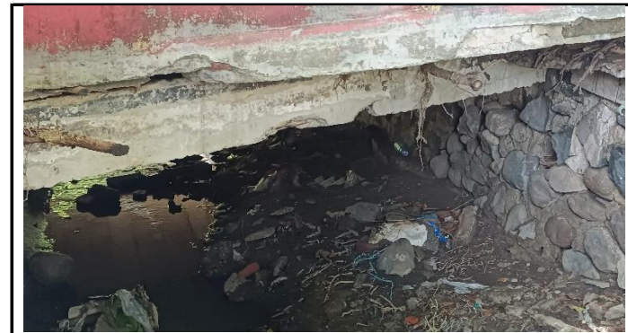
PELAT JEMBATAN KEROPOS DAN RONTOK PADA BETON
