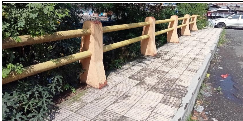
KONDISI SANDARAN DAN TROTOAR
