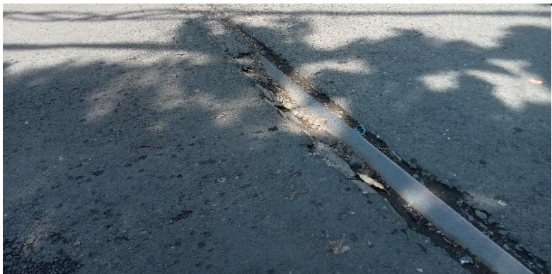
KONDISI SAMBUNGAN SIAR MEMUAI
