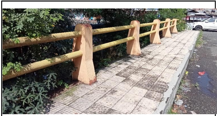
KONDISI SANDARAN DAN TROTOAR
