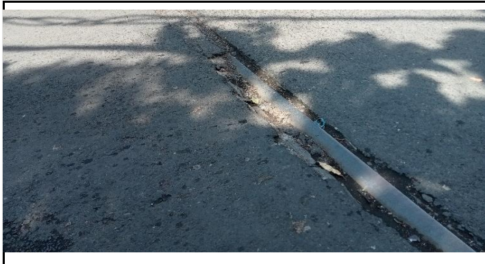
KONDISI SAMBUNGAN SIAR MEMUAI
