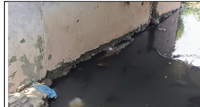
PONDASI JEMBATAN TERGERUS
