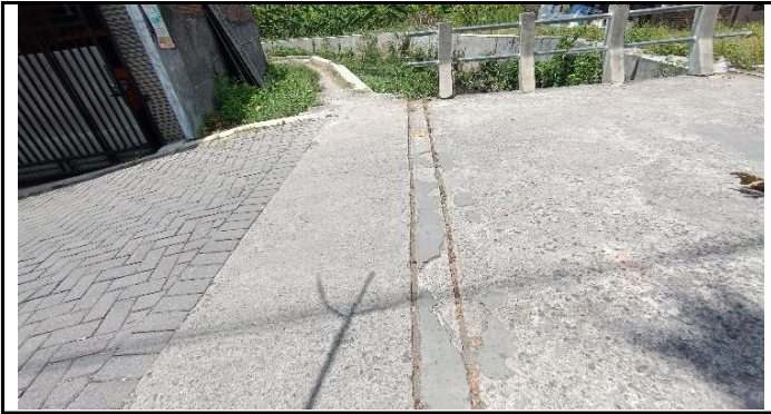
JALAN BERLUBANG PADA LANTAI JEMBATAN
