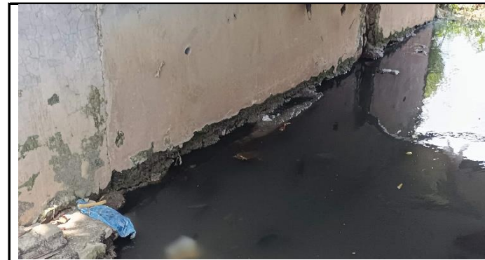
PONDASI JEMBATAN TERGERUS
