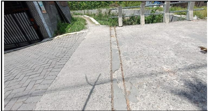
JALAN BERLUBANG PADA LANTAI JEMBATAN
