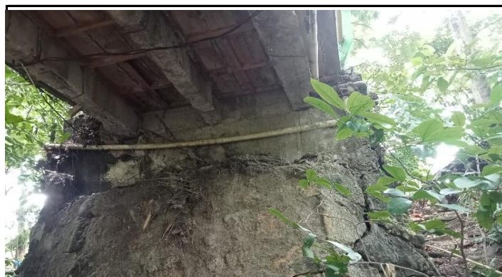
DINDING KEPALA JEMBATAN PECAH
