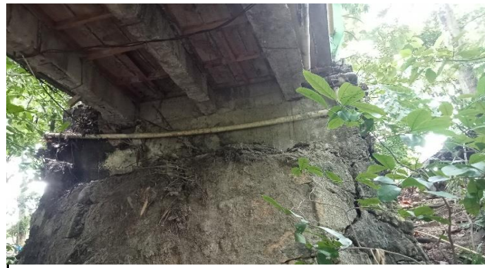
DINDING KEPALA JEMBATAN PECAH
