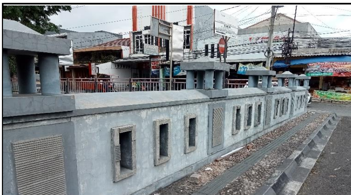
KONDISI TROTOAR DAN SANDARAN
