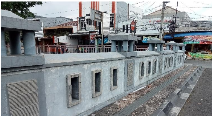
KONDISI TROTOAR DAN SANDARAN
