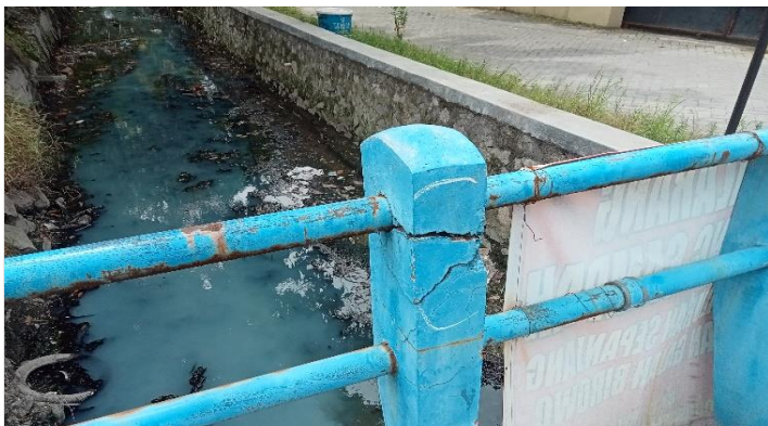
TIANG SANDARAN PECAH
