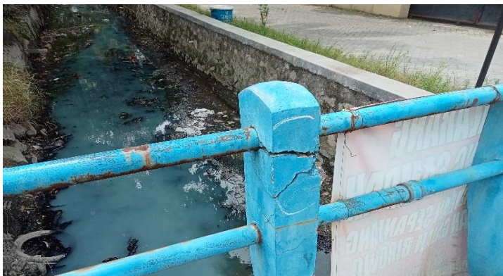
TIANG SANDARAN PECAH
