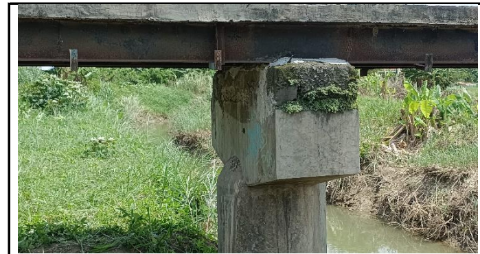
PILAR KOTOR BERLUMUT DAN MENGALAMI PENUAAN
