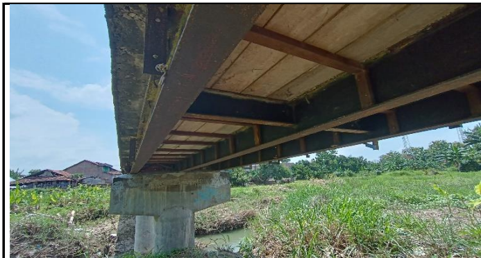
GELAGAR JEMBATAN BERKARAT
