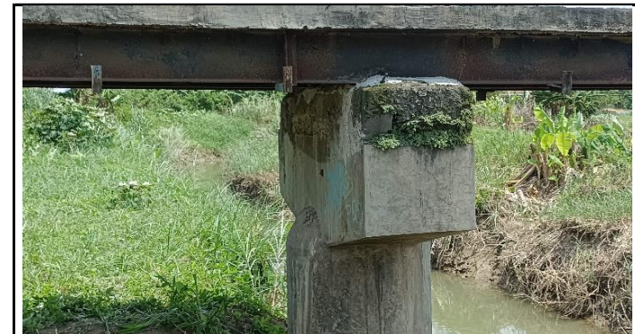
PILAR KOTOR BERLUMUT DAN MENGALAMI PENUAAN
