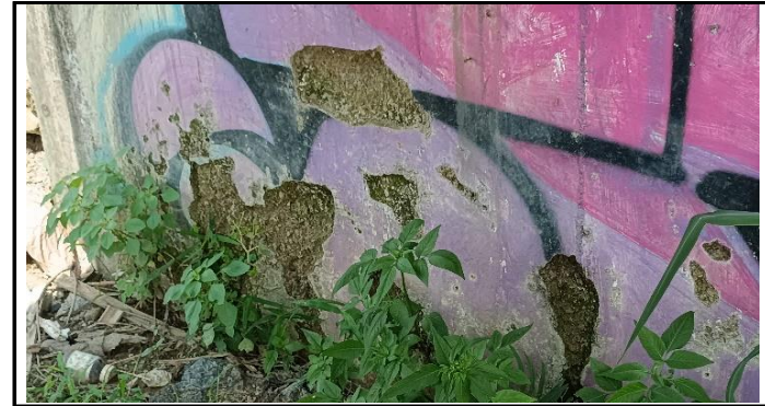
KEPALA JEMBATAN KEROPOS DAN KERONTOKAN BETON
