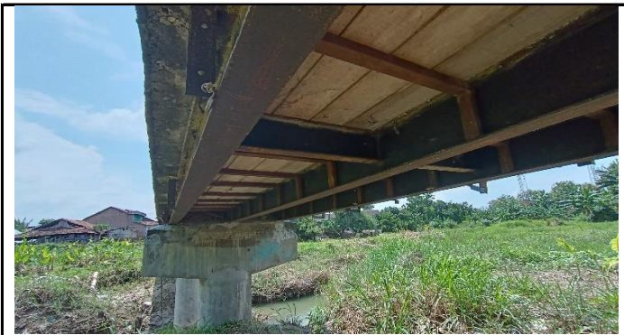
GELAGAR JEMBATAN BERKARAT
