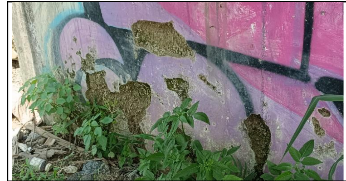
KEPALA JEMBATAN KEROPOS DAN KERONTOKAN BETON
