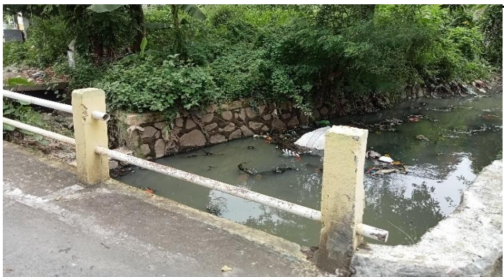
SANDARAN HORIZONTAL TIDAK ADA DI SALAH SATU SISI
