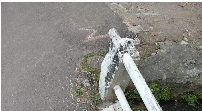
TIANG SANDARAN PECAH
