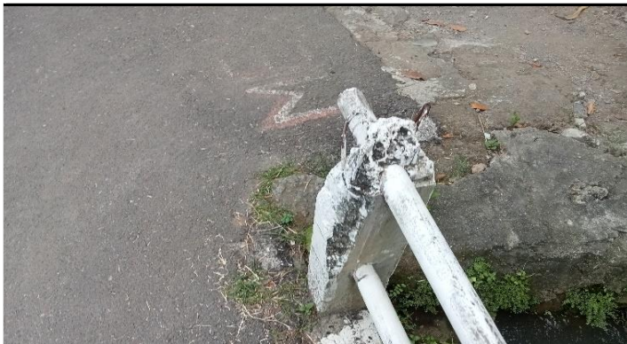
TIANG SANDARAN PECAH
