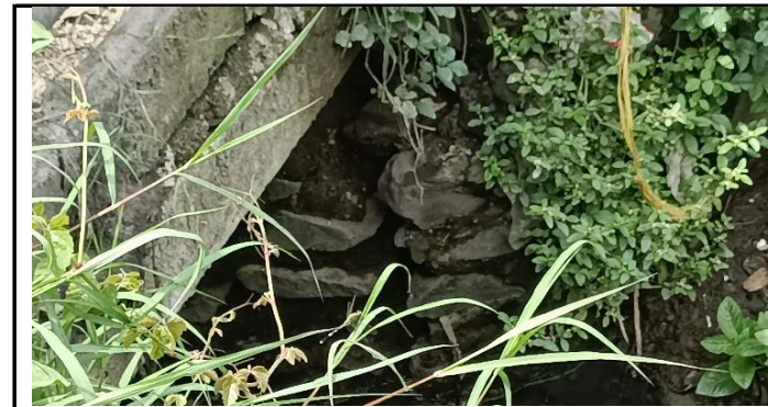
PENURUNAN MUTU BATU PADA KEPALA JEMBATAN
