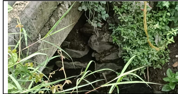
PENURUNAN MUTU BATU PADA KEPALA JEMBATAN
