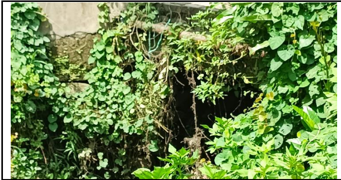
STRUKTUR LANTAI JEMBATAN KEROPOS DAN PENUAAN
