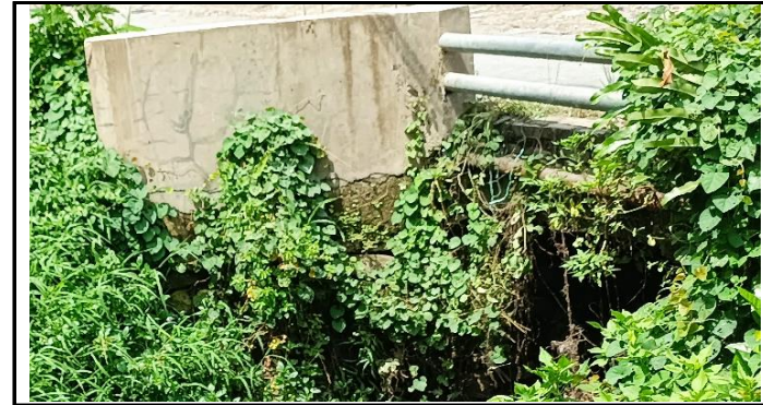
DINDING PENAHAN TANAH JALAN PENDEKAT RETAK
