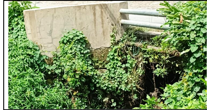
DINDING PENAHAN TANAH JALAN PENDEKAT RETAK
