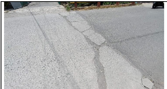
KERETAKAN PADA JALAN PENDEKAT
