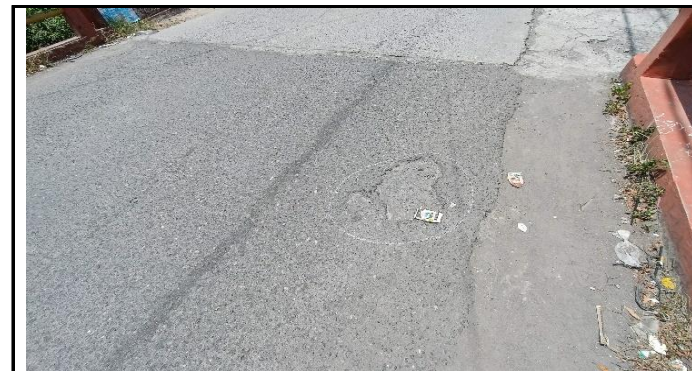
LAPISAN PERMUKAAN LANTAI JEMBATAN BERGELOMBANG
