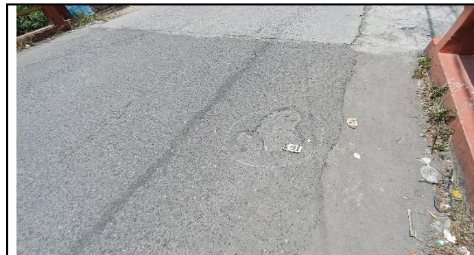
LAPISAN PERMUKAAN LANTAI JEMBATAN BERGELOMBANG
