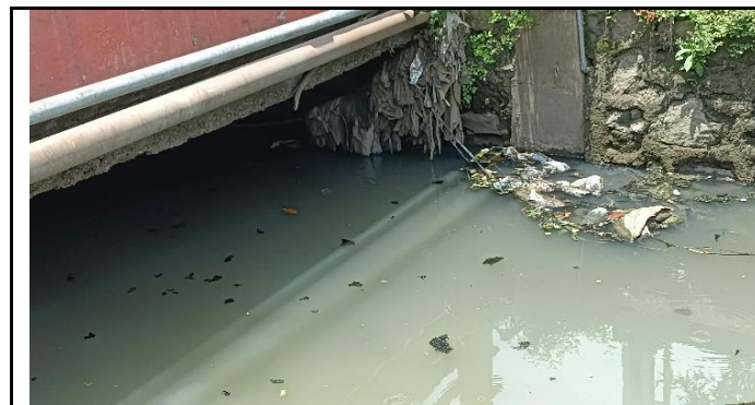
KEPALA JEMBATAN MENGALAMI PENURUNAN MUTU
