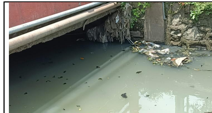
KEPALA JEMBATAN MENGALAMI PENURUNAN MUTU
