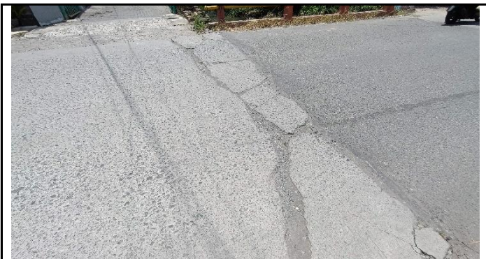
KERETAKAN PADA JALAN PENDEKAT
