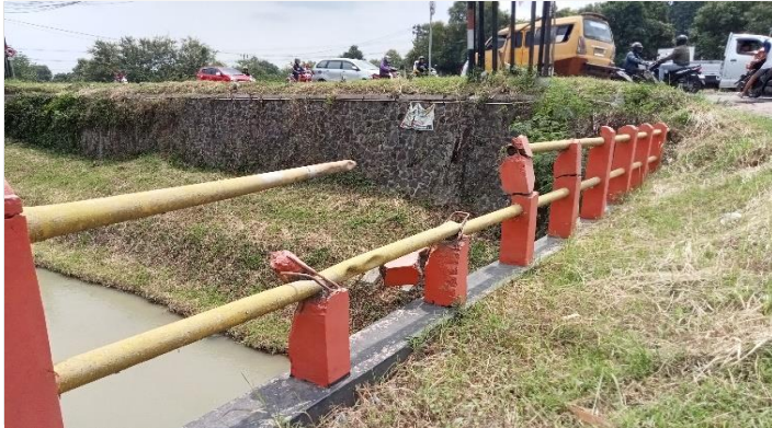
TIANG SANDARAN PECAH
