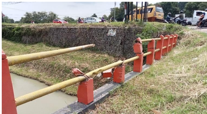
TIANG SANDARAN PECAH
