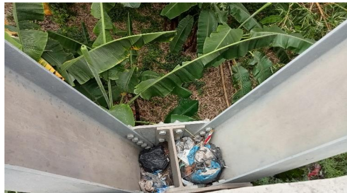
TUMPUKAN SAMPAH DI ELEMEN JEMBATAN
