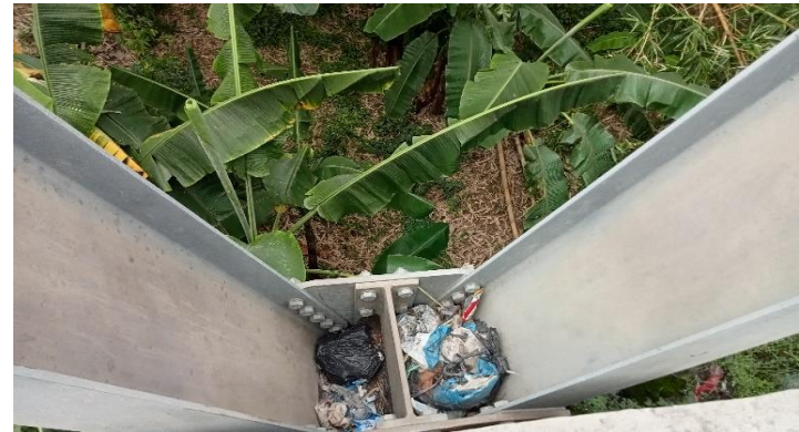
TUMPUKAN SAMPAH DI ELEMEN JEMBATAN
