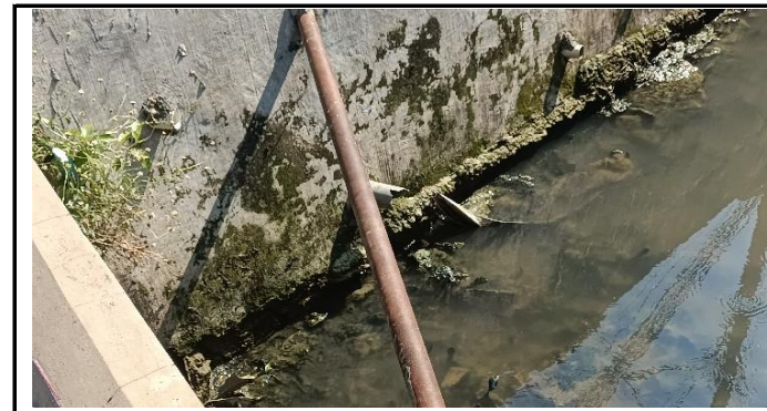
KONDISI UTILITAS PIPA AIR MINUM
