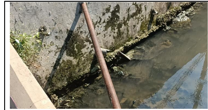
KONDISI UTILITAS PIPA AIR MINUM
