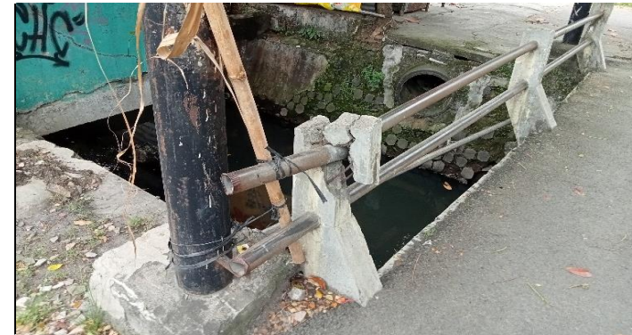
TIANG SANDARAN PECAH
