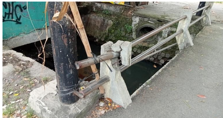
TIANG SANDARAN PECAH
