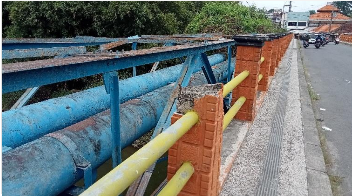
TIANG SANDARAN PECAH
