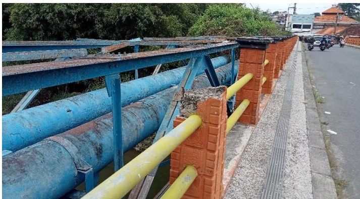
TIANG SANDARAN PECAH
